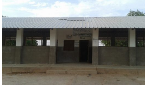
Kuva 4: Uusi koulu ja aurinkopanelit
